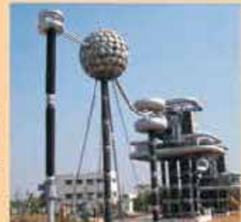
1200kV CVT under test
