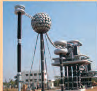
1200KV CVT under test
